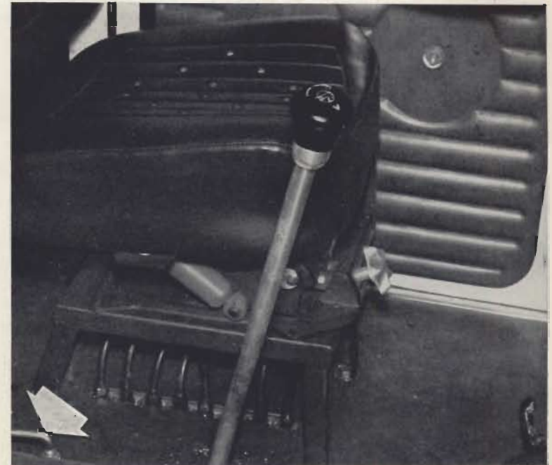
Fig. 1.9. - Interruptor general baterías
