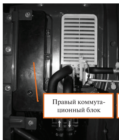
Рисунок 8-48 Правый коммутационный блок кабины
